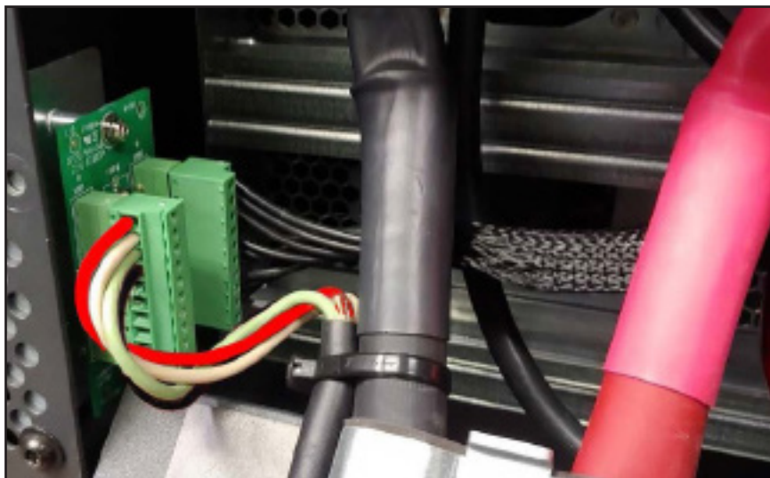
Figura 21 Cables de comunicación de la batería conectados a la terminal de tornillo
