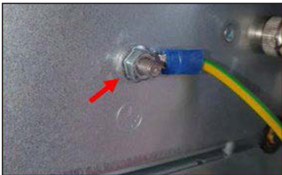
Figura 27 Desconexión del cable de tierra
